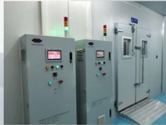
Zentrale Steuerung für den thermostatischen Raum
